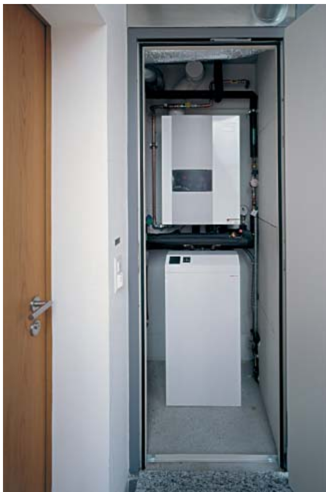
Gas-Wandkessel und Boiler für individuelle Wohnungsheizung in einem Minergie-Mehrfamilienhaus in Buchs SG. Chaudière murale à gaz et chauffe-eau pour chauffage individuel d'un appartement dans une maison plurifamiliale Minergie éditée à Buchs SG.
