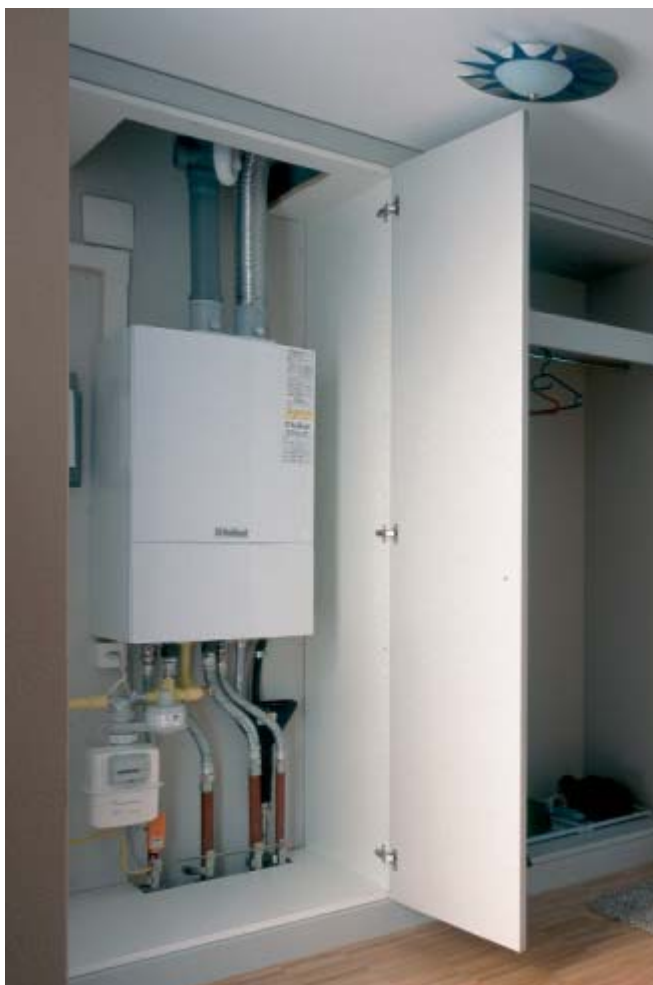
Gas-Kondensations-Wandkessel in einem Schrank (Einfamilienhaus) Chaudière murale à gaz à condensation installée dans une armoire (villa familiale)
