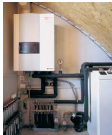
Dachheizzentrale mit einem Gas-Kondensationsbund Chaufferie en toiture avec une chaudière à gaz à condensation
