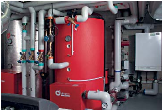
Solar-Wärmespeicher und Gas-Wandkessel in einem Minergie-Mehrfamilienhaus in Nyon. Accumulateur thermique solaire et chaudière murale à gaz dans une maison plurifamiliale Minergie à Nyon.
